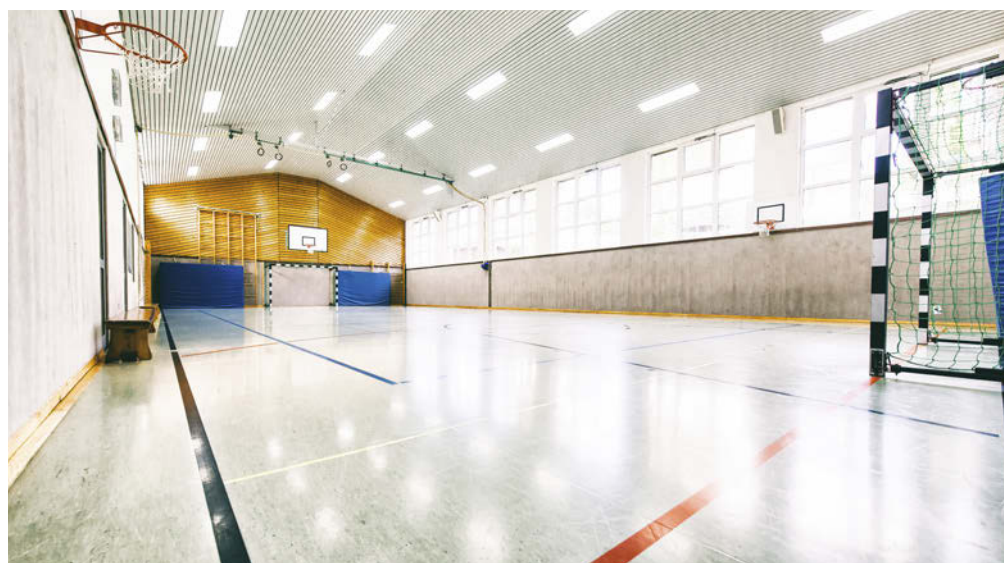
Eine energieeffiziente Sanierung der Hallenbeleuchtung senkt den Energieverbrauch und reduziert die Betriebskosten.
